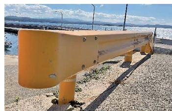
【オレンジ色のガードレール】
